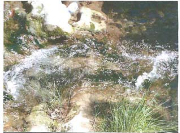
Une buse domine la rivière neuve ; cette buse recueille les eaux et elle est située au droit des locaux PIZZORNO. Un liquide couleur grise sort de cette buse et se déverse directement dans la rivière Le Las
